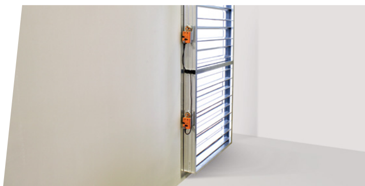
Detalle compuerta motorizada
